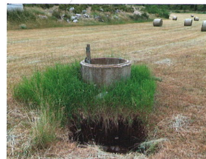
Trou ouvert dans la prairie en surface lors de la crue de mai 2012. La buse en béton à gauche est l'entrée de la cavité. En très forte crue, l'eau déborde par le haut dans l'embut. Cliché P. Mazoué.
